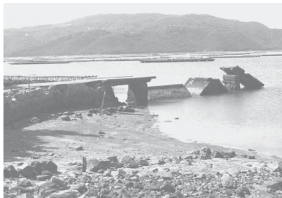
写真③ 崩れ落ちた収容棧橋（長島愛生園）
